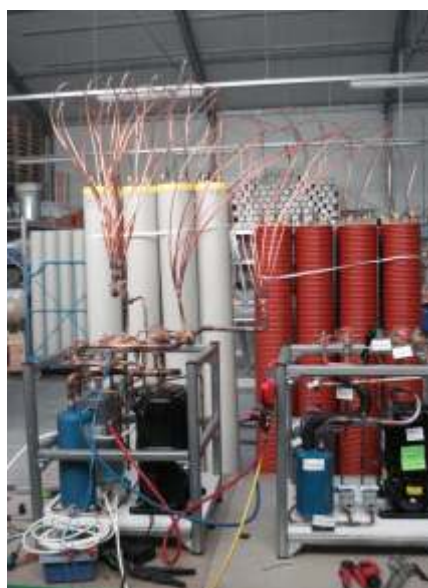
Kondensator- und Verdampferlatenzellen, Venturi-Verteilung und Kompressoren
